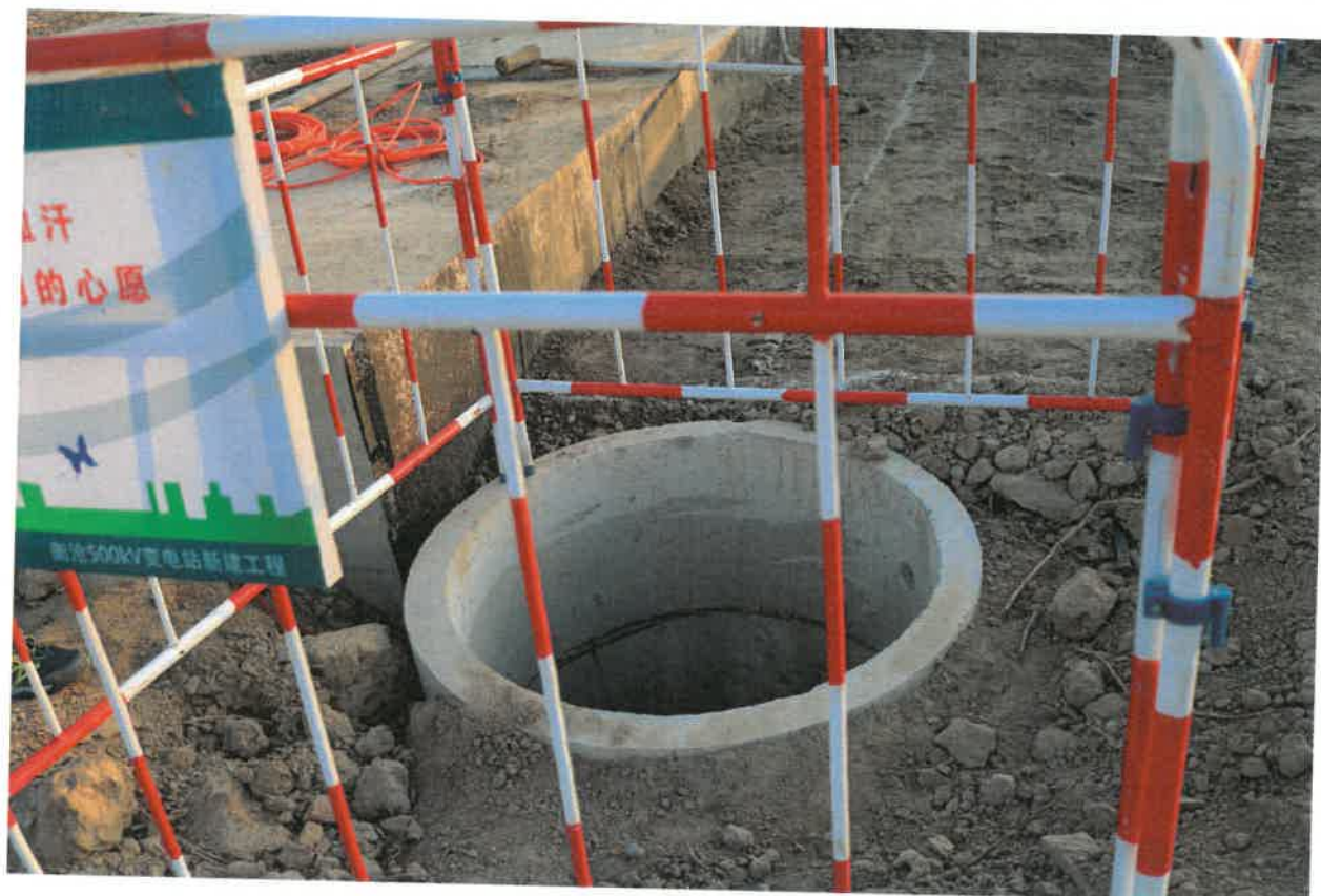
站内排水管道
