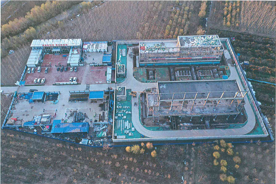
变电站及施工区（2021.11.15）
