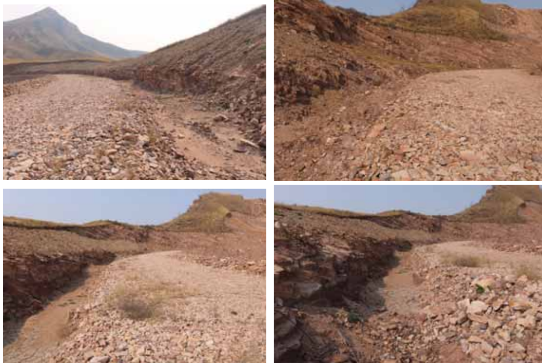
道路区临时排水沟
