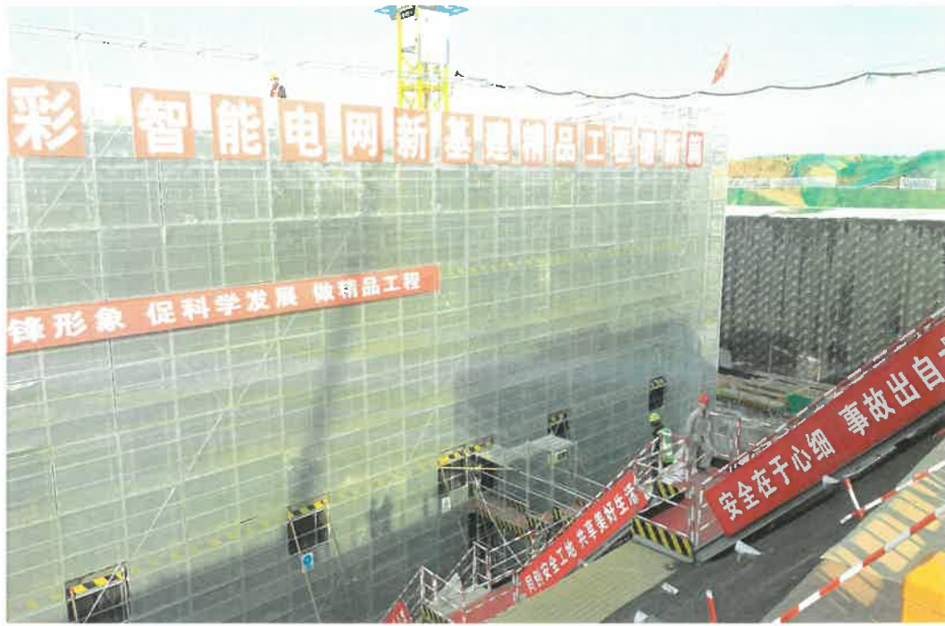
河西 110kV 变电站
